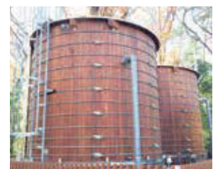
都内療育センターで使用している木製受水槽
