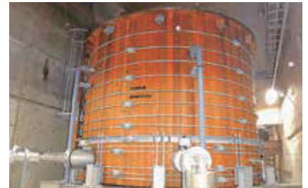
江戸東京博物館に設置した木製受水槽
