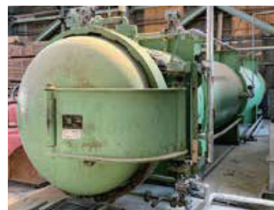
不燃処理装置
