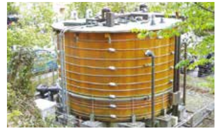
瀬音の湯で使用されている木製受水槽
