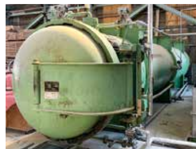
不燃処理装置
